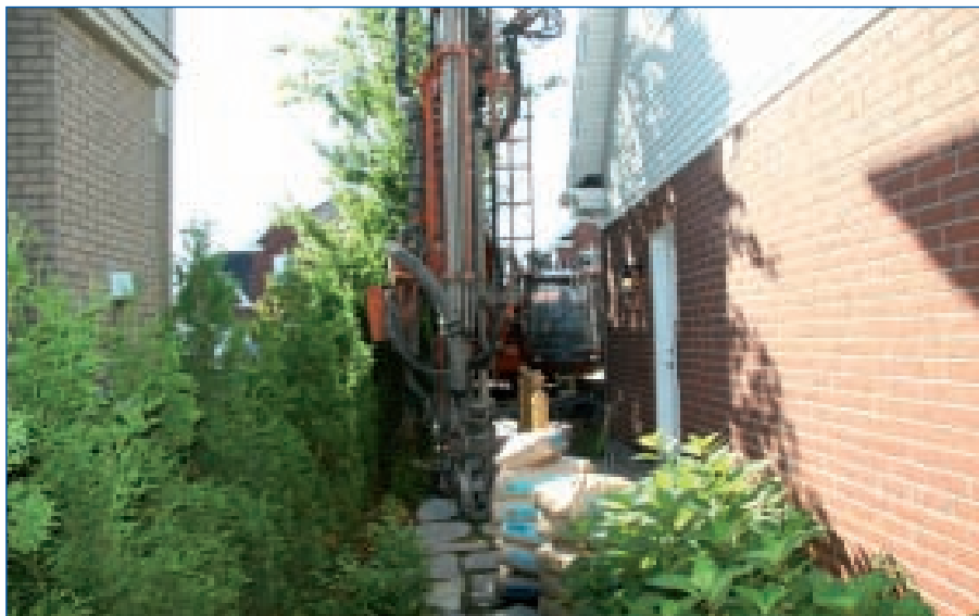
La géothermie à expansion directe utilise une technique de forage moins invasive qui permet de s'approcher plus près des fondations. Le procédé se fait sans eau et ne produit pas de boue de forage.
